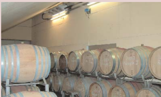
Ein Düsenbefeuchter (oben Mitte) sorgt im Barriquekeller des Weingutes Karl Haidle für eine optimale Luftfeuchte
