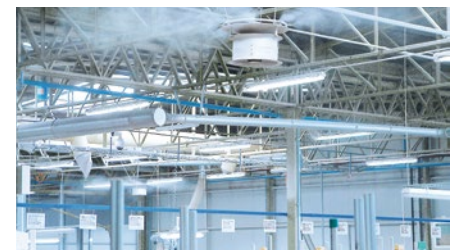
Das System ML Princess ist energieeffizient und einfach zu erweitern
