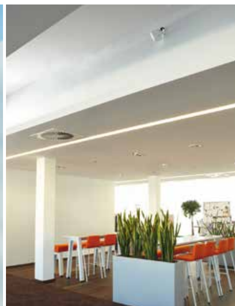
Die Lüfterneuerung übernimmt die Raumlufttechnik (links an der Decke ein Drallausslass). Für ausreichende Luftfeuchte sorgen Hochdruckzerstäuber (rechts oben).
