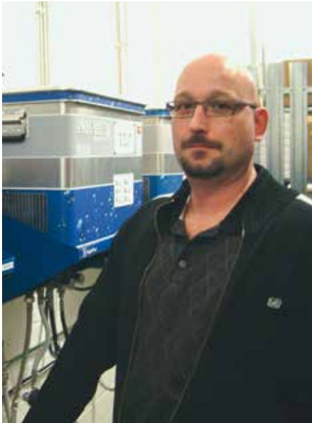
Für Peter Seitz ist die Wartung der Wasseraufbereitung mit den wenigen Handgriffen des halbjährlichen Austauschs der Service-Container erledigt.
