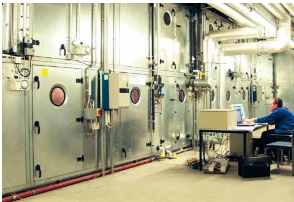
Der Fachverband Gebäude-Klima e. V. mahnt Betreiber seit langem, die mit der EnEV verordnete energetische Inspektion von Klimaanlage durchzuführen. Der Befeuchtung kommt bei Wartung und Inspektion eine besondere Bedeutung zu.
