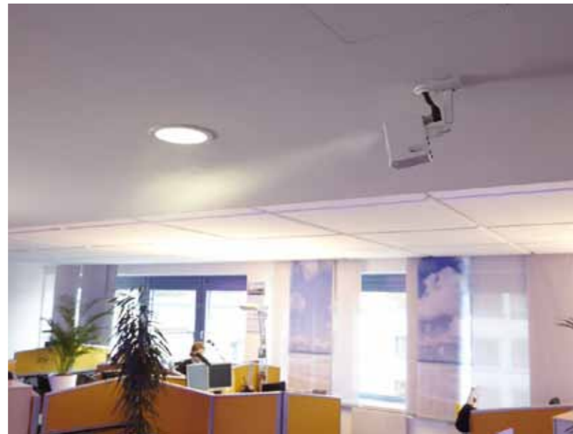
Eine Luftbefeuchtung in Callcentern hat positiven Einfluss auf Gesundheit und Wohlbefinden.
